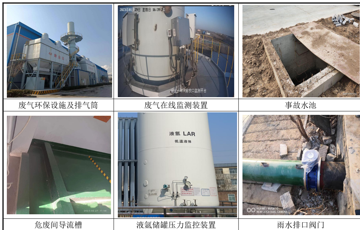
图 7.1-1 现有工程采取的风险防范措施现场照片
