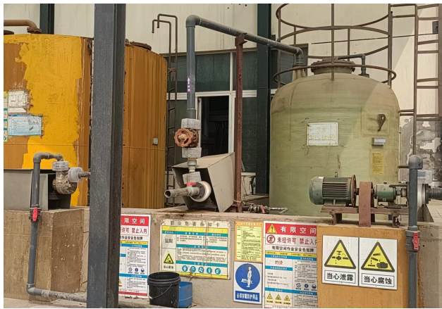
铜箔污水处理用盐酸（右）、液碱（左）储罐
